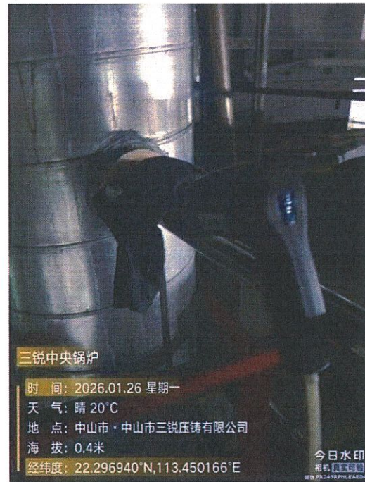
中央熔炉燃烧废气排放口
