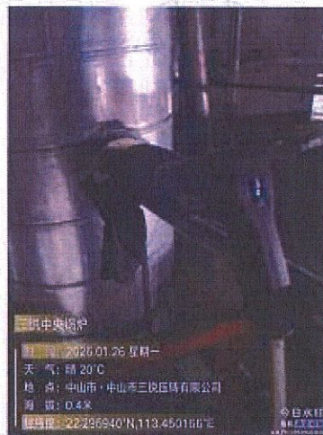
中央熔炉燃烧废气排放口
